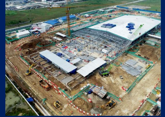
JKT 05 Data Center - Cikarang
