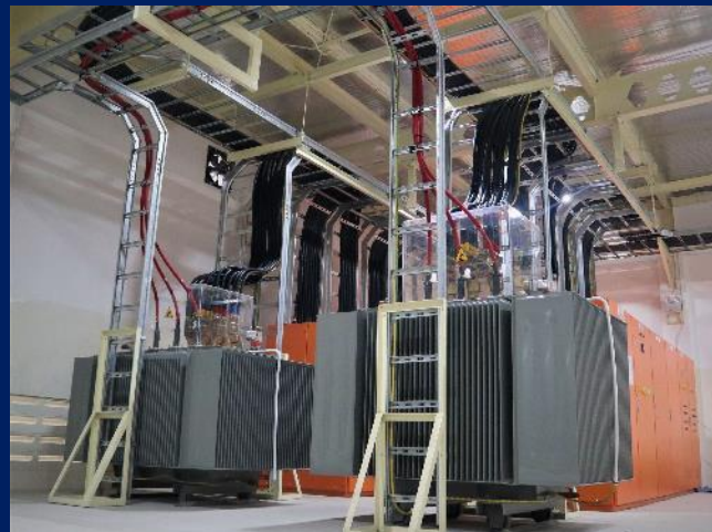
Trafo - LV MDB
