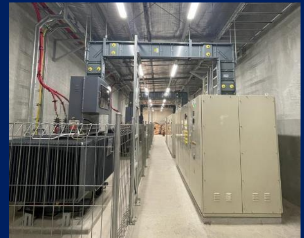
Trafo - LV MDB
